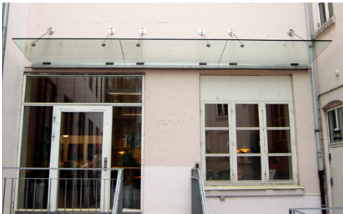
Glasbaldakin ophængt i rustfri stålstag, der er h.h.v. indlimet i murværket og boltet gennem glasset med specialfremstillede rustfri beslag. Specialfremstillede tagreuder i glasblæst stål fungerer samtidig som bæringer for glasset
